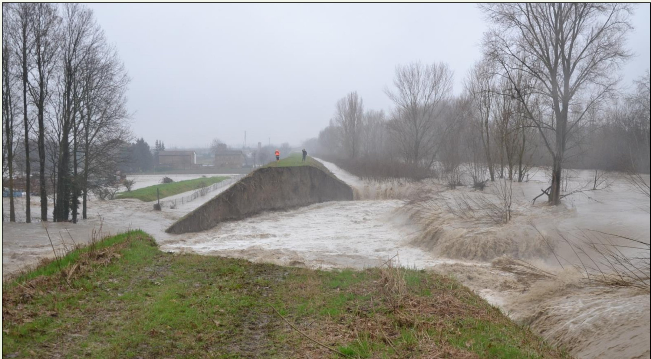
Fig.1 Collasso arginale avvenuto nella frazione di San Matteo di Modena in destra idrografica del fiume Secchia.
